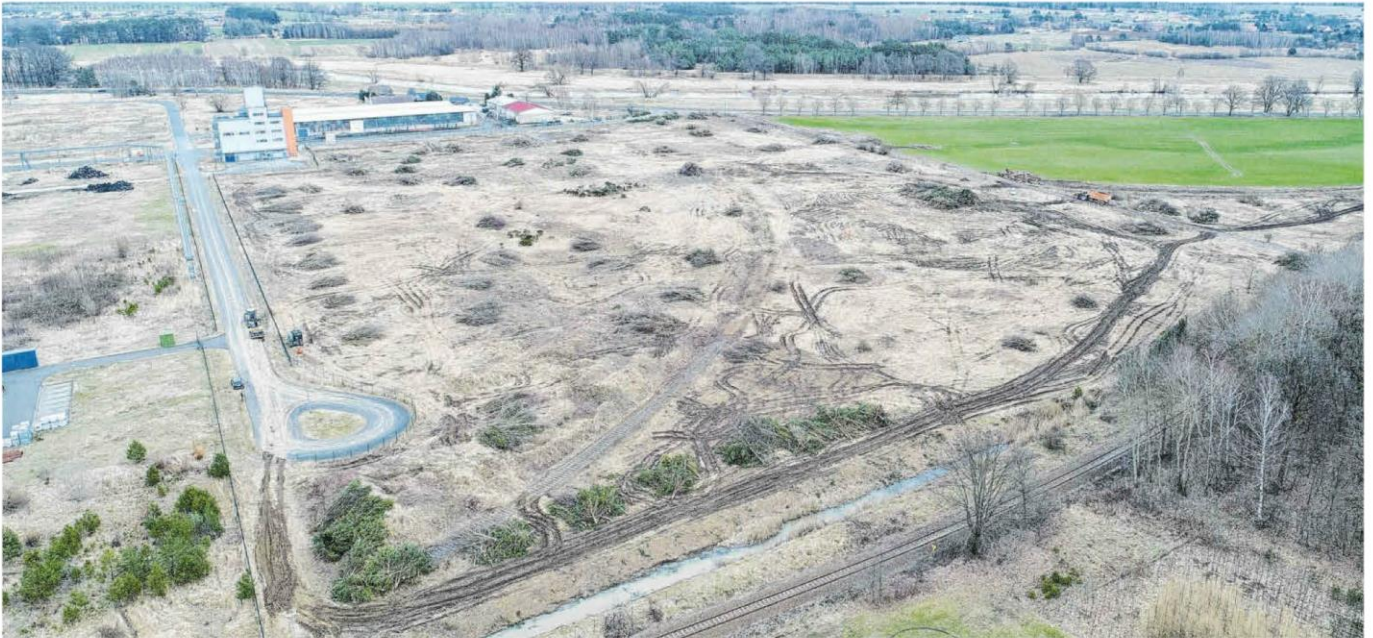
Im Gubener Industriegebiet an der Forster Straße laufen bereits die vorbereitenden Arbeiten für die Ansiedlung der Firma Rock Tech.
