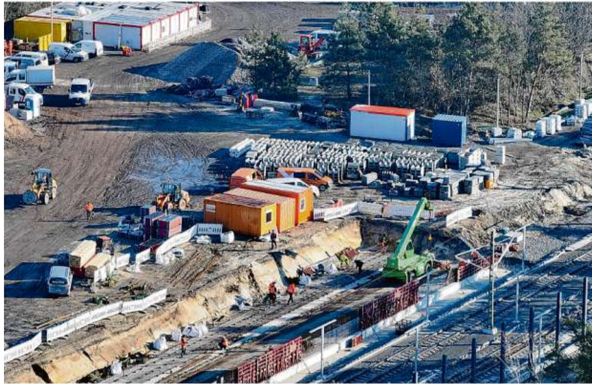
In der Nähe des Heizkraftwerkes (in Cottbus entsteht derzeit eine neue Logistikkreislaube, eine Art Güterbahnhof). Aber es sind weitaus größere Investitionen nötig, um die Transportkapazitäten in der Lausitz zu erhöhen.
